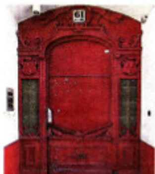
Marode: die Tür vor der Restaurierung. Foto: privat
